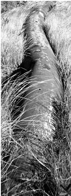
Рис. 1 Образование гофра на трубопроводе.
